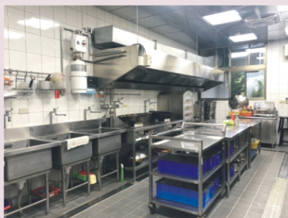
【廚房】新置水幕式油煙罩、炒爐、湯爐、蒸爐等專業廚具，設置截油槽，為環境保護盡心力。
