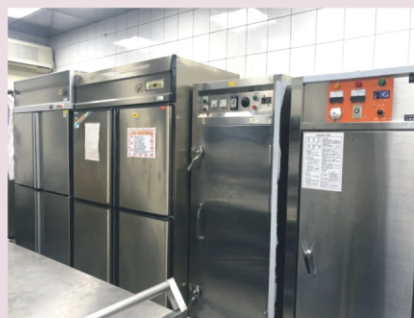
【廚房】增置冷凍及消毒設備，食品保存和器具消毒更無虞。並改裝天然氣及滅火系統，安全保護更上一層樓。
